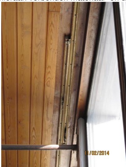
Bestaand railsysteem grote zaal volledig te vernieuwen
