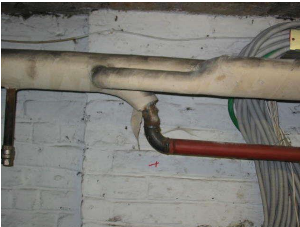
Foto 8: isolatie leidingen kelderruimte (huisnr. 3)
