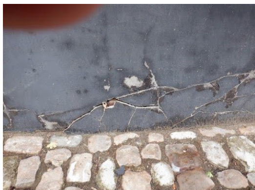
gebarsten en loskomende cementtering van de plint
