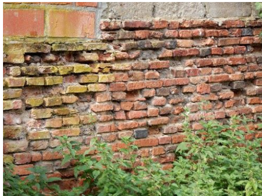
verweerde stenen en ontbrekend voegwerk
