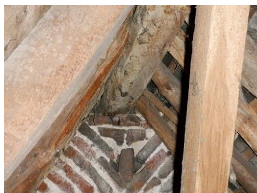
oud vocht ter plaatse van oplegging nokbalk
