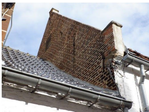
verroeste ankers op kopgevel.
