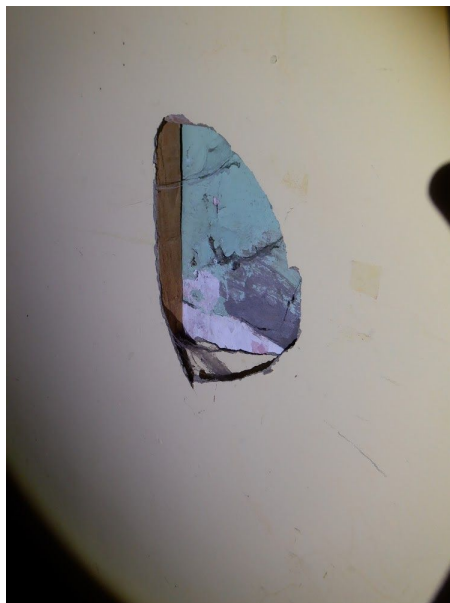
vermoedelijk asbesthoudende wandbekleding
