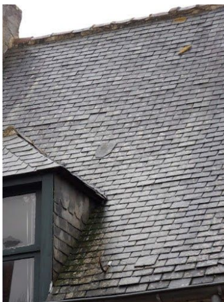
gebroken en uitgeschoven leien
