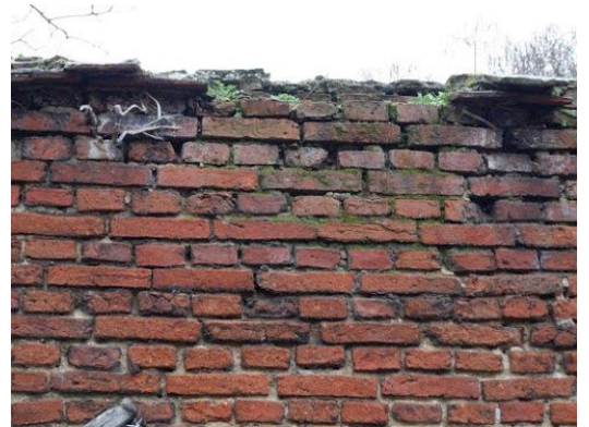
ontbrekend voegwerk en vochtinfiltraties
