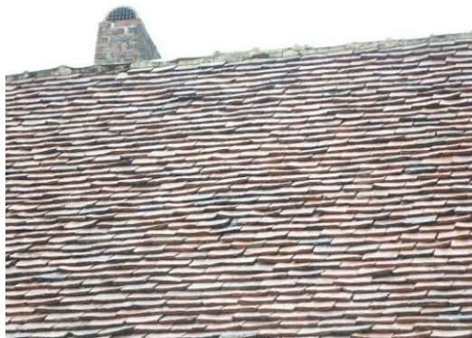
enkele gebroken tegelpannen
