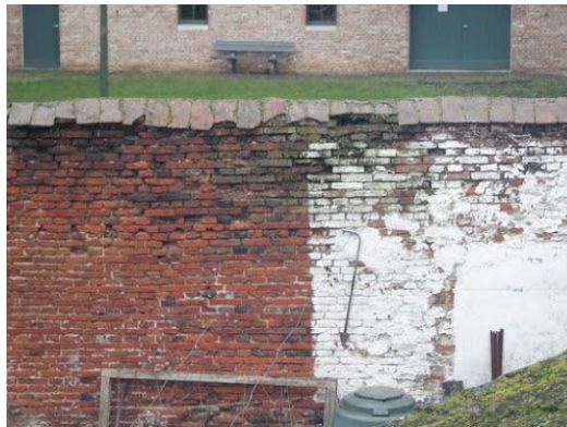
verweerde bakstenen en beschadigde afdekking
