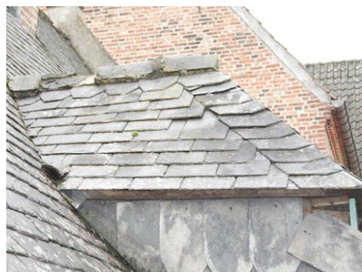
beschadigde nok, en leien
