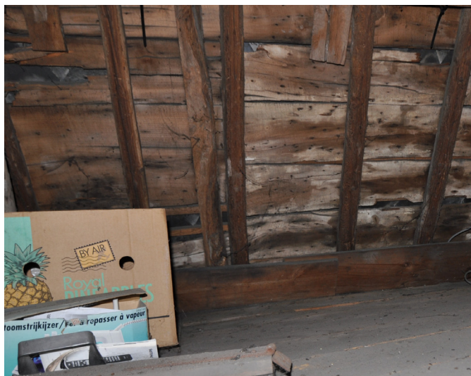
afb. 36 Detail dakopbouw, ontbrekende en beschadigde bebording.
