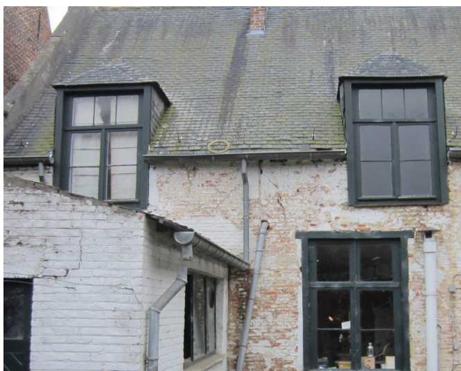
afb. 39 Dakkapellen achtergevel en vervuild metselwerk
