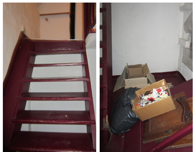
afb. 41-42 Verdiepingstrap, beschadigingen en ontbreken van trappaal en leuning
